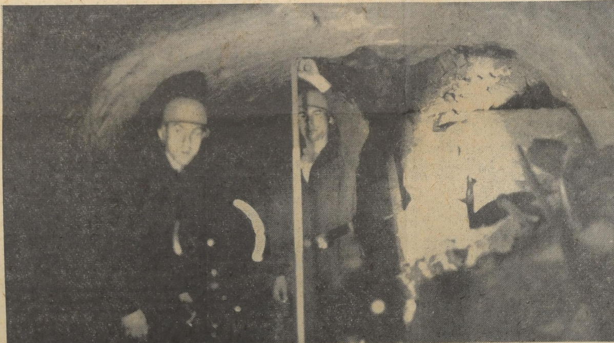
Mit starken Scheinwerfern hatten die THW-Männer den Kellerteil ausgeleuchtet, der durch Sandsteinquadern und dahinterliegendes Erdreich verschlossen worden war. Ein Vordringen von dieser Seite aus erwies sich, da das Erdreich immer wieder nachbrach, als undurchführbar.
